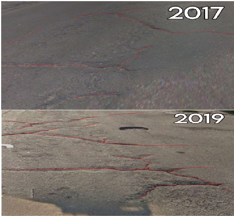
Рисунок 3 – Прогрессию небольших дефектов в опасное нарушение дорожного полотна в связи с отсутствием ямочного ремонта можно наблюдать и по улице Тамбовская г. Курска
